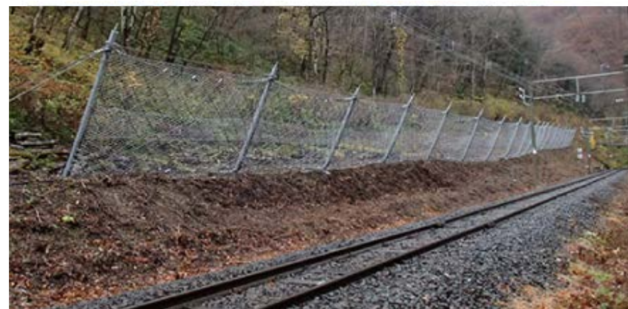
＜雪崩対策：線路沿い＞
