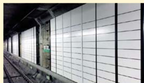
地下鉄構内壁面 (キズ・汚れ防止)
